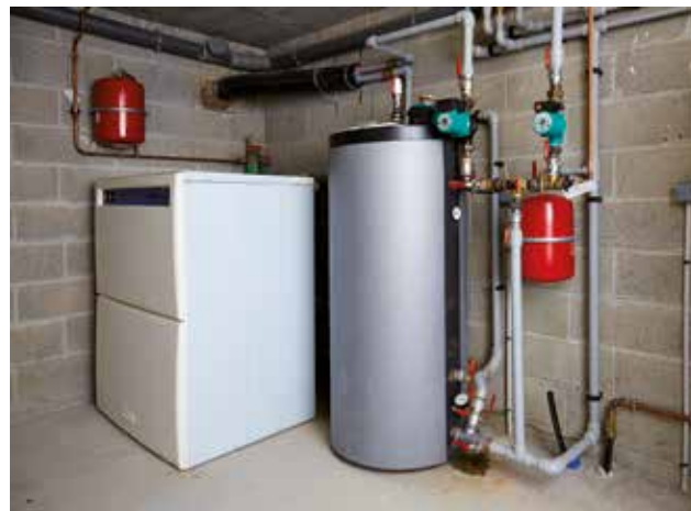
Une pompe à chaleur géothermique est généralement associée à un ballon tampon qui stocke l'eau chaude pour la distribuer au bon moment dans le réseau de chauffage.
